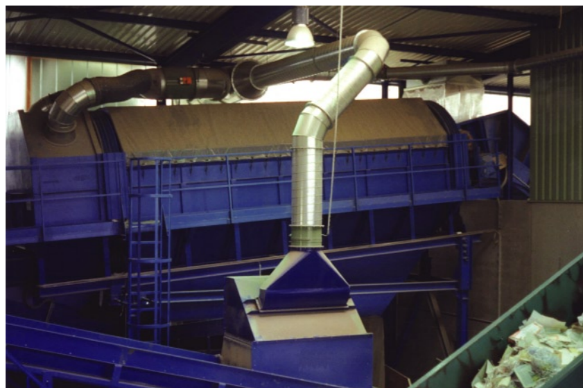
Stauberfassung an einem Mischer
